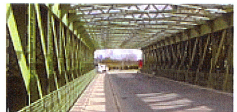
Ende des 19. Jahrhunderts vom Jugendstilarchitekten Otto Wagner erbaut, wurde die Schamerbrücke 2009 einer Generalsanierung unterzogen. Grund waren Korrosionsschäden am Stahltragwerk der historischen Brücke. Jetzt schützen Beschichtungssysteme von Rembrandtin die berühmte Jugendstilbrücke mit den steinernen Löwen vor gefährlichen Umwelteinflüssen.
